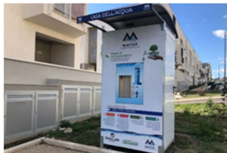
La casa dell'acqua installata presso il Matera Social Housing
